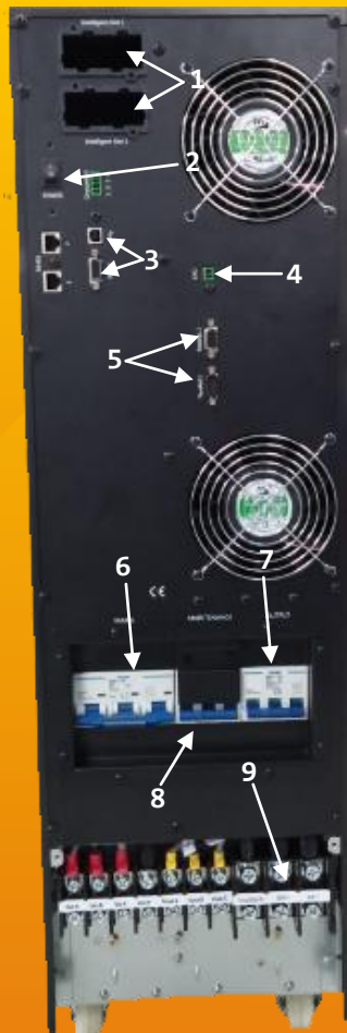
ИБП вид сзади:
